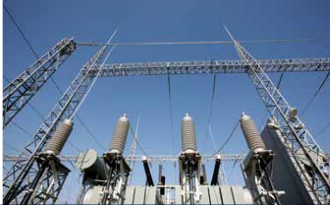
Ahal-3 Basit Çevrim Elektrik Santrali
