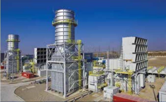
Ahal-2 Basit Çevrim Elektrik Santrali
