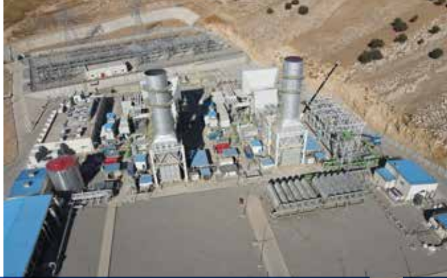
Bazyan Basit Çevrim Elektrik Santrali
